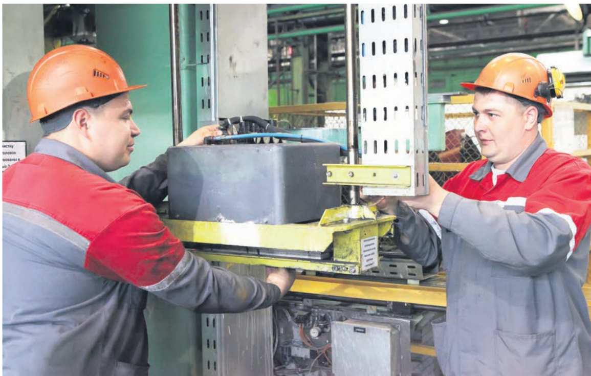
△ Рационализаторы ТЭСЦ-4 исправили заводскую недоработку в конструкции оборудования
